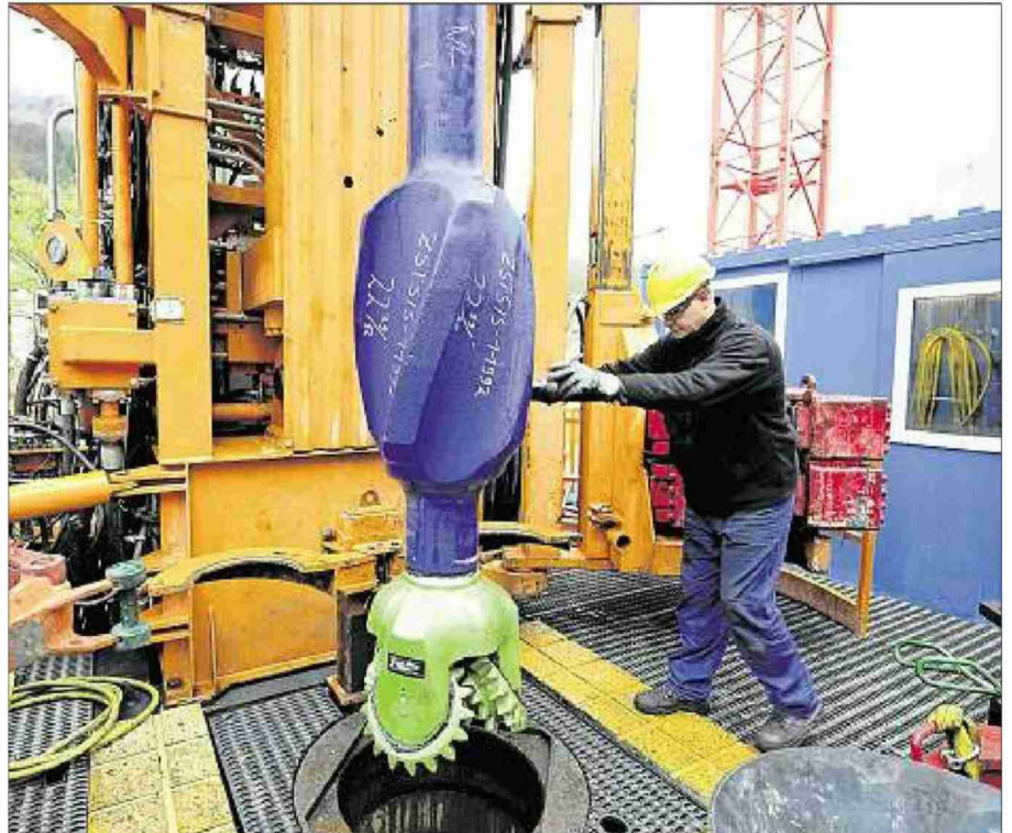
Ein solcher riesiger Bohrmeissel für die Geothermie-Erkundungsbohrung wie im Zürcher Triemli-Quartier soll im kommenden Jahr in St. Gallen nach heissem Wasser bohren. (Key)
