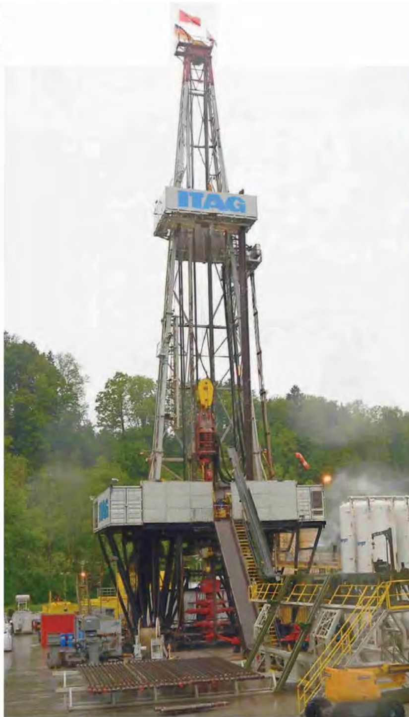
Der Bohrturm RIG23 bohrt für einmal nicht nach Gas oder Öl, sondern nach Erdwärme.
